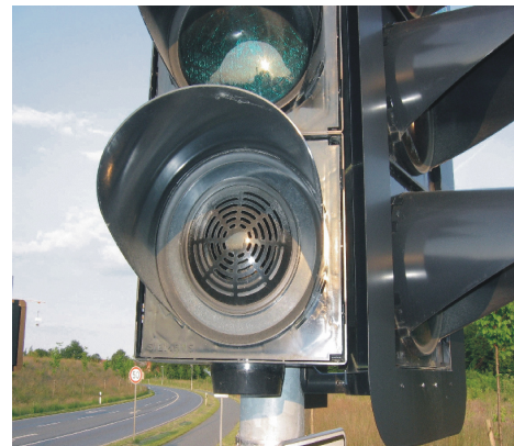
Akustischer Signalgeber in LSA integriert
