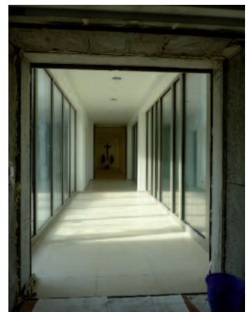
Blick aus dem Erschließungsflur des Bestandsgebäudes nach Norden in den neuen Gang. Abb. 54
