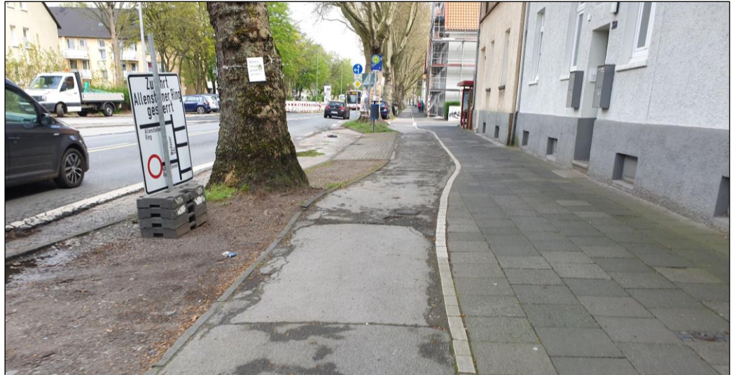
Abbildung 30: Schlechte Oberflächenqualität eines getrennten Geh- und Radweges ohne Benutzungspflicht entlang der Wedauer Straße (Quelle: Eigene Aufnahme)
