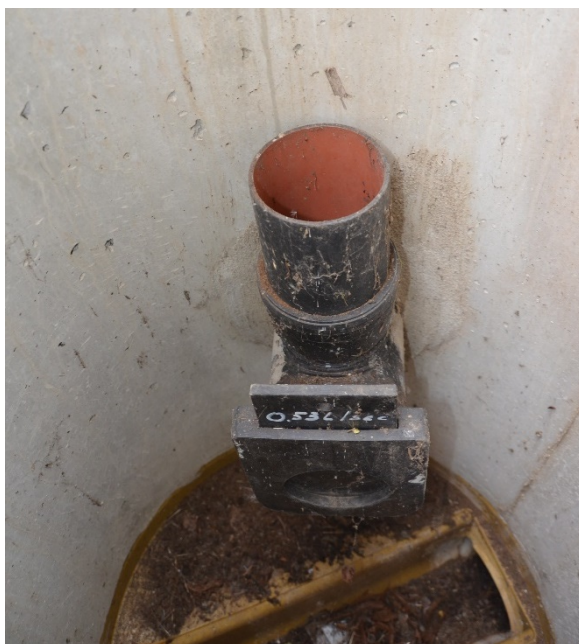
Abbildung 78: Lochblendendrossel mit intensivem Eintrag von Laubresten im Schachtboden. Bei kleinen Durchmessern ist regelmäßige Prüfung der Ablaufleistung unbedingt notwendig
