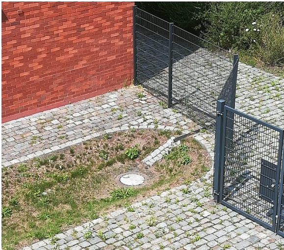
Abbildung 77: Einbau des Drosselschachts innerhalb der Mulde mit Anordnung der Schacht-abdeckung vor dem Einlauf und auf der Muldensohle führt zum Ausfall der Retentions- und Reinigungsleistung
