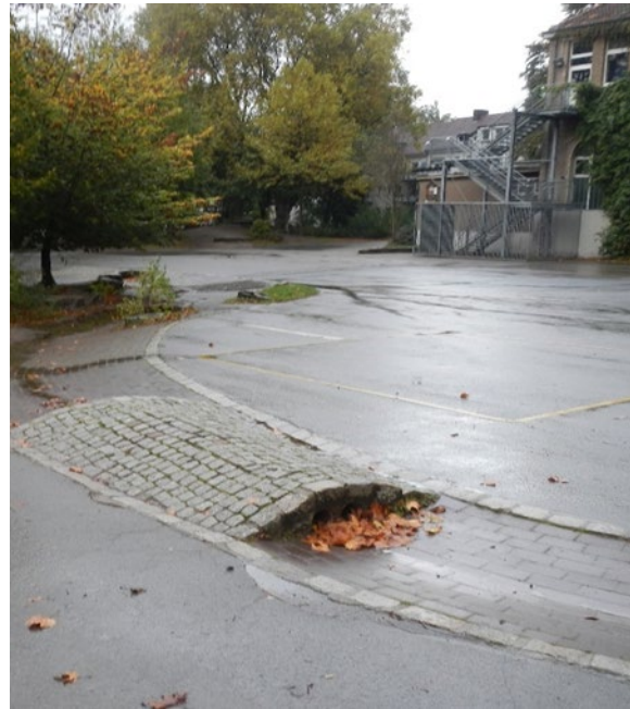
Abbildung 22: Offene Rinne mit Rohrdurchlass. Laubablagerungen vor dem Durchlass kann Wasserfluss gänzlich verhindern
