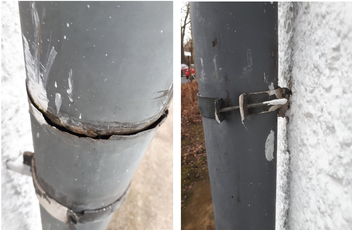
Abbildung 1: Abrutschen eines Fallrohrs (links) aufgrund loser Schraubschellen (rechts)
