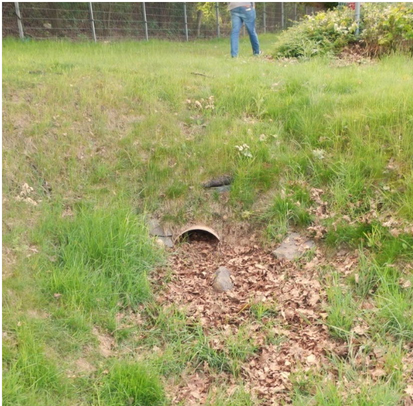
Abbildung 46: Rasenrinne mit Übergang zu Verrohrungen im ungepflegten, nicht mehr funktionsfähigen Zustand
