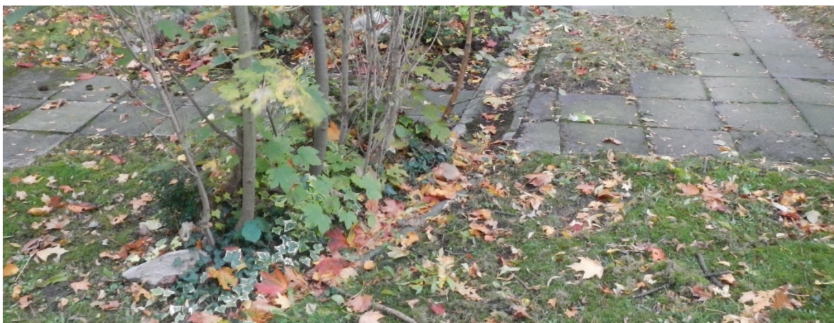
Abbildung 27: Ablagerung im Übergangsbereich von befestigter Rinne zu Rasenrinne mit einsetzender Sedimentbildung in der Pflasterrinne. Wild abfließendes Wasser ist zu erwarten
