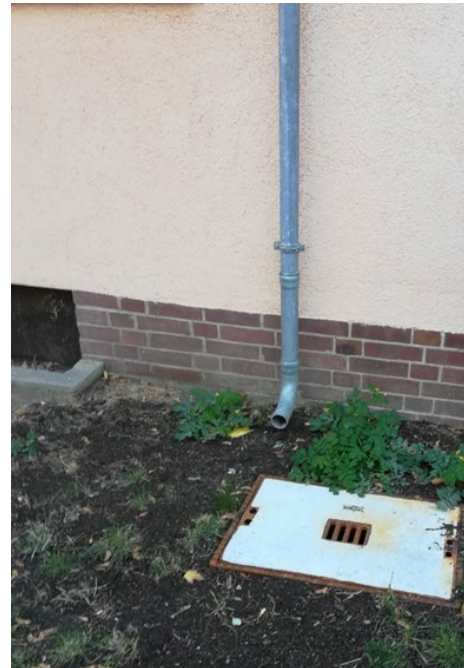
Abbildung 18: Fehlender Rinnenanschluss mit hohem Schadenspotenzial für Keller und Schacht
