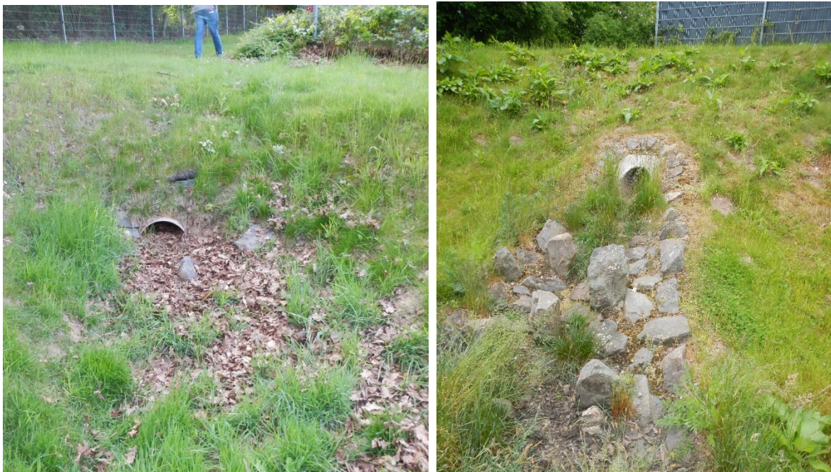
Abbildungen 61 & 62: Funktionsverlust einer Zuleitung durch fehlenden Höhensprung und mangelhafte Unterhaltung (links); freier Rohrauslass mit Kolktschutz und Höhensprung (rechts)
