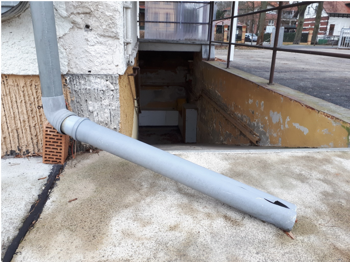
Abbildung 2: Unsachgemäße Fixierung eines Fallrohrkrümmers ohne Schraubschelle. Lockere Rohrverbindung, da Spitzende nicht zur Muffe passt. Hohes Schadenspotential durch die angrenzende Kellerzuwegung.
