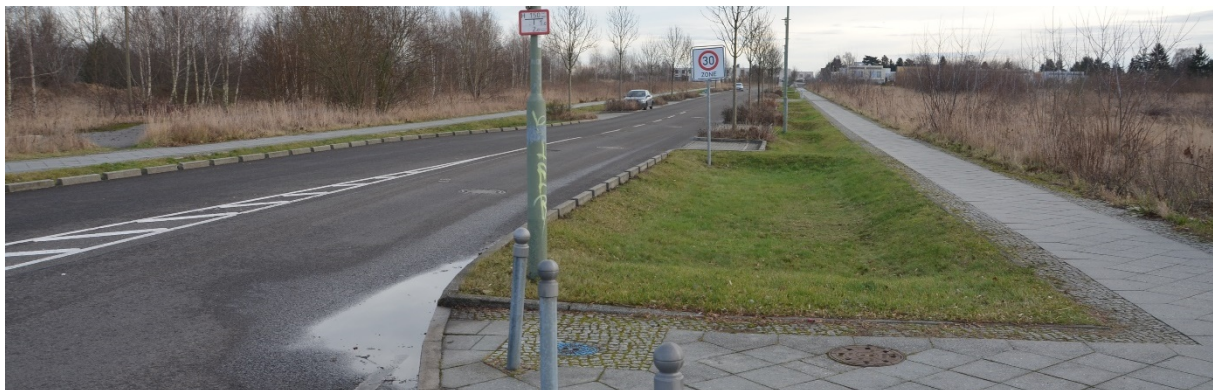
Abbildung 74: Mulden-Rigolen-System im ordnungsgemäßen Zustand mit flächigem Zulauf und kaskadierten Mulden
