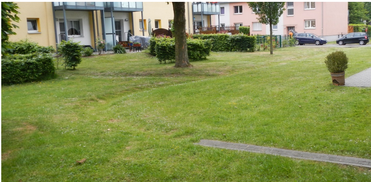
Abbildung 26: Ordnungsgemäß gepflegter Übergang von befestigter Rinne zu Rasenrinne ohne Laubablagerung, Instandhaltung der Grasnarbe und durchgehendes Fließgefälle
