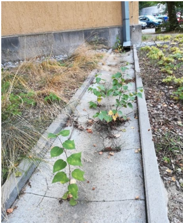
Abbildung 19: Initialer Einwuchs in offene Rinne aufgrund unterlassener Pflege. Bei fortschreitender Entwicklung ist mit Hebung der Muldensteine zu rechnen
